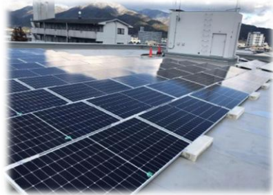
上下水道部庁舎でのPPA事業
